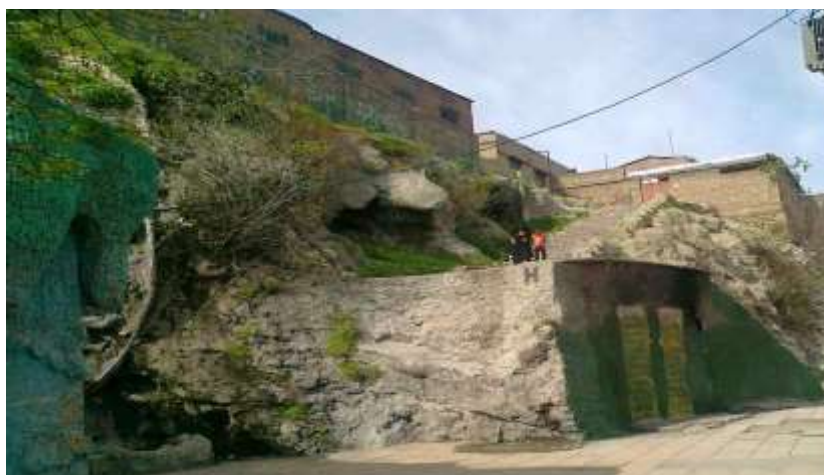
شکل ۵: ساخت‌وساز نامناسب در نواحی پرشیب در منطقه شمشیرآباد خرم‌آباد
